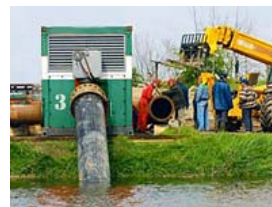
Les stations de pompage étaient placées à Annecy-le-Vieux, Annecy, et aux Marquisats.
